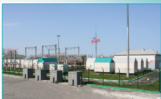
Тяговая подстанция переменного тока 25 кВ "Береговая" (Северо-Кавказская железная дорога)
