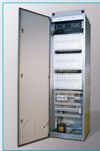
Шкаф управления разъединителями
