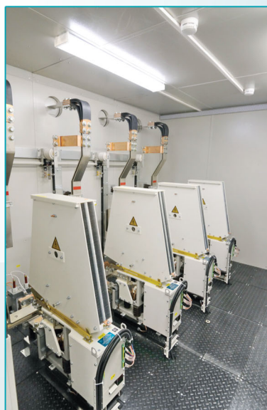
Высоковольтный отсек поста секционирования постоянного тока ПС-3-2
