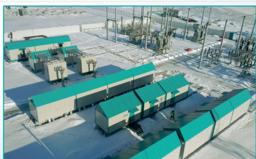
Подстанция 110/27,5/10/3,3 для Энгельского локомотивного завода
