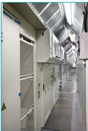
Функциональные блоки распределительного устройства 2х25 кВ Одностороннее обслуживание. Выполнены на базе шкафов серии "1С-2х25" или аналогичных. Ток главных цепей блока до 2000 А. Количество шкафов в блоке – до 3 шт.
