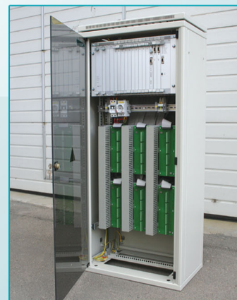
Шкаф КП-Б (ТП)
