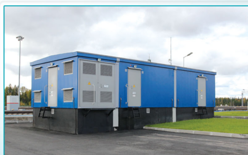
БКТПБ на станции Лужская – Сортировочная
