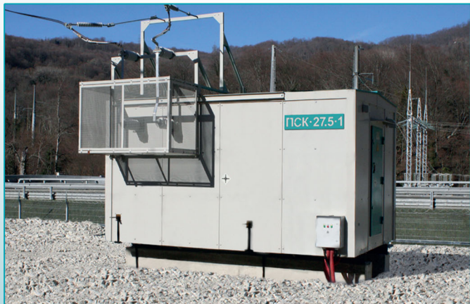
Пост секционирования переменного тока ПС-25-1 Северо-Кавказской железной дороги
