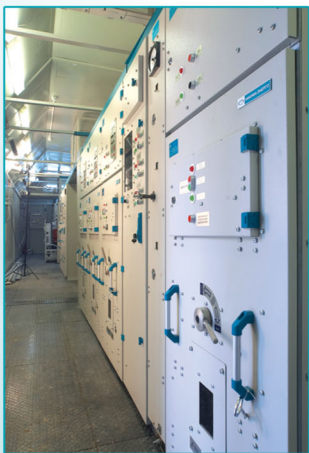
Комплектное распределительное устройство постоянного тока на напряжение 1,65 кВ серии "КВ-1,65" Одностороннее обслуживание, внутренняя установка, воздушная изоляция, использование выкатных выключателей серии ВАБ-206 с током главных цепей до 4000 А.
