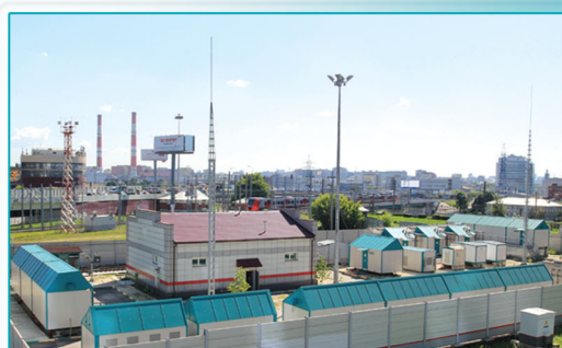
Тяговая подстанция постоянного тока "Москва-Киевская" 3,3 кВ транспортно-пересадочного узла остановочного пункта "Кутузовская" Московского центрального кольца
