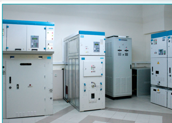
Учебная тяговая подстанция в ПГУПС (Санкт-Петербург)
