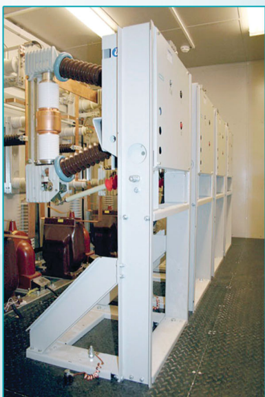
Высоковольтный отсек поста секционирования переменного тока ПС-25-2
